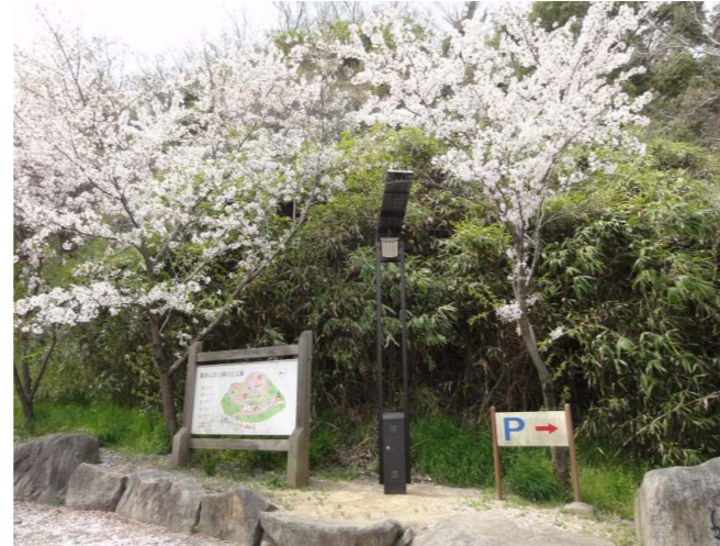
津波一時待避所照明灯設置業務委託 亀島 発注者/倉敷市 ソーラー照明灯 ソライト FSL-TF-TR90 2基
