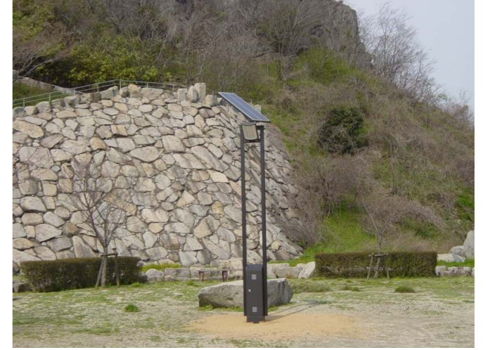
津波一時待避所照明灯設置業務委託 亀島 発注者/倉敷市 ソーラー照明灯 ソライト FSL-TF-TR90
