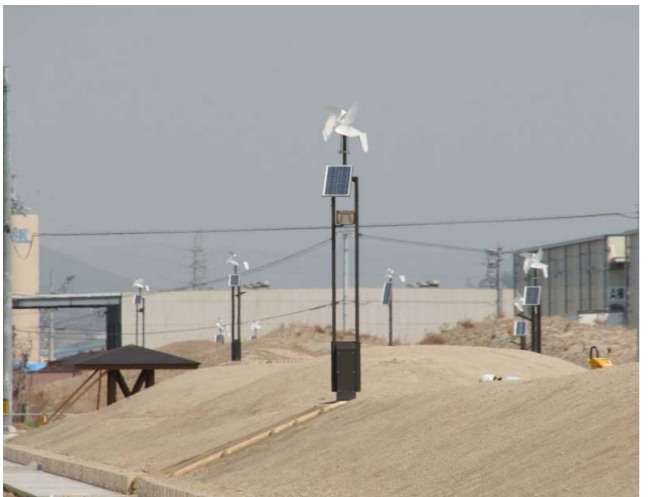
玉島ハーバーアイランドエコパーク 発注者/岡山県備前県民局 ハイブリッド照明灯 フーライト HBS-TF2-SD-TR63 2基 HBS-TF-TR63 11基
